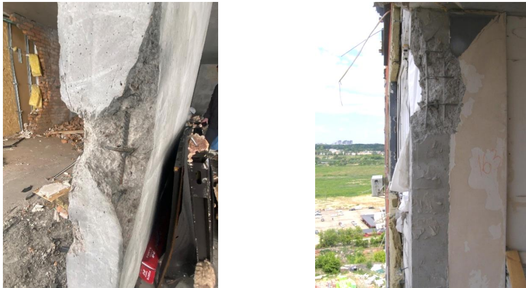
Часткове руйнування бетону пілона з оголенням арматурної сітки Рисунок 4.3 – Приклад пошкоджень середнього характеру залізобетонних вертикальних конструкцій
