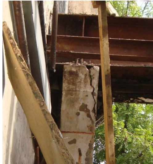
Рисунок 1.7 – Відкол бетону в місці розташування закладної деталі залізобетонної колони
