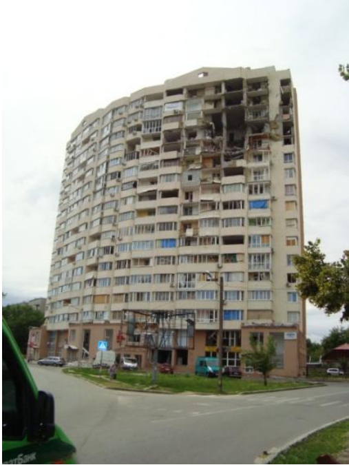
Рисунок 3.1 – Пошкоджена будівля в м. Чернігові
