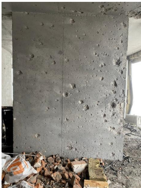
Пошкодження бетону залізобетонного пілона
