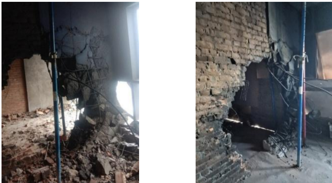
Рисунок 2.14 – Залізобетонний пошкоджений пілон
