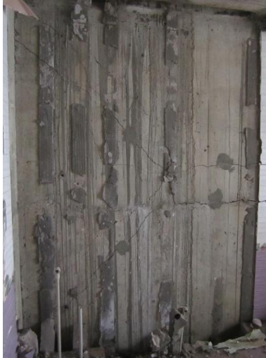
Рисунок 1.6 – Загальний вигляд тріщин у пілоні будівлі (вертикальні, горизонтальні, похилі)
