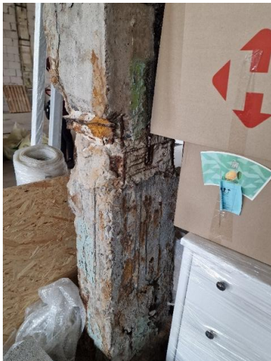
Рисунок 1.8 – Оголення та корозія арматури
