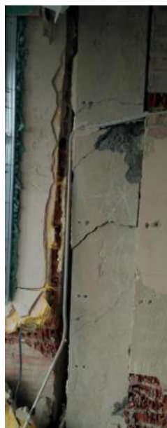
Вертикальна тріщина та пошкодження бетону пілона
