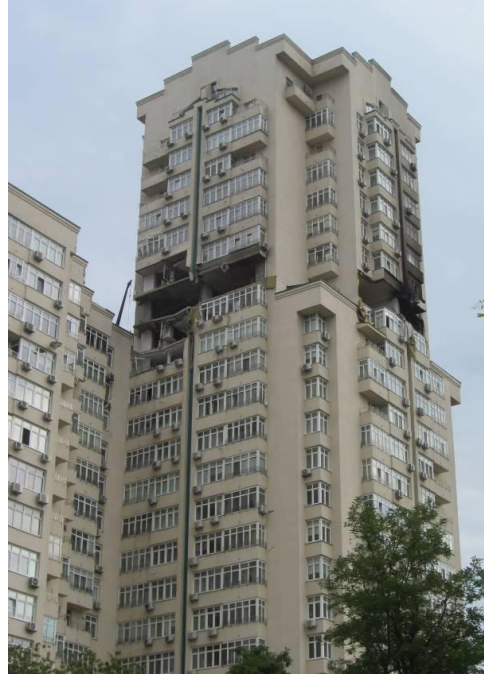
Рисунок 3.2 – Пошкоджена будівля в м. Києві
