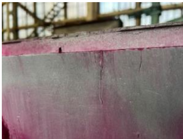
Рисунок 3.34 – Виявленні тріщини на поверхні металевих листів
